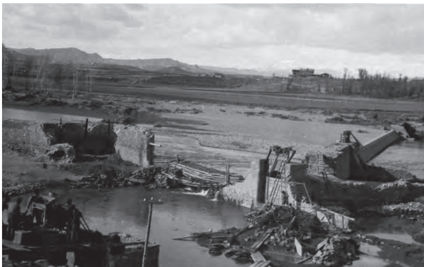
Obres de reparació de la resclosa de la fàbrica, després de l'aiguat del mes d'octubre del 1940. Arxiu Oliva-Rifà.
