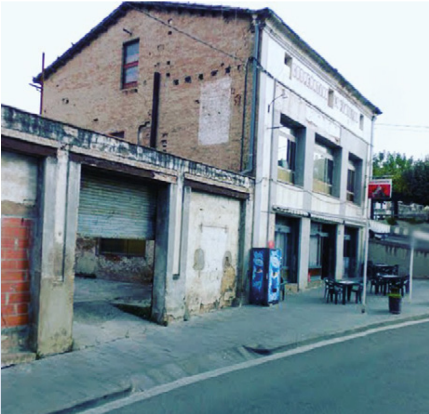
L'edifici de la cooperativa, en un estat bastant avançat de degradació (2009) (Font: Damià Bas)
